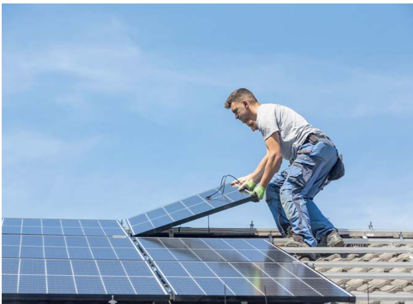
Les installations solaires suffisamment adaptées au toit ne nécessitent pas une autorisation de construire. ADOBE STOCK
